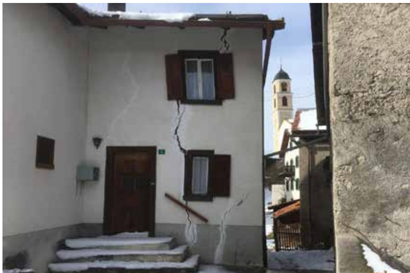
Vor allem ältere Häuser zeigen massive Schäden.
