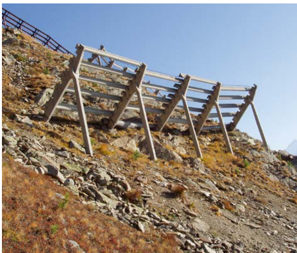
Verbauungen aus Beton haben sich nicht bewährt und müssen sukzessive durch Werke aus Stahl ersetzt werden.
