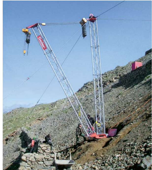
Für die Instandstellung der Steinmauern entwickelte eine in Pontresina ansässige Firma einen flexibel einsetzbaren Kran .
