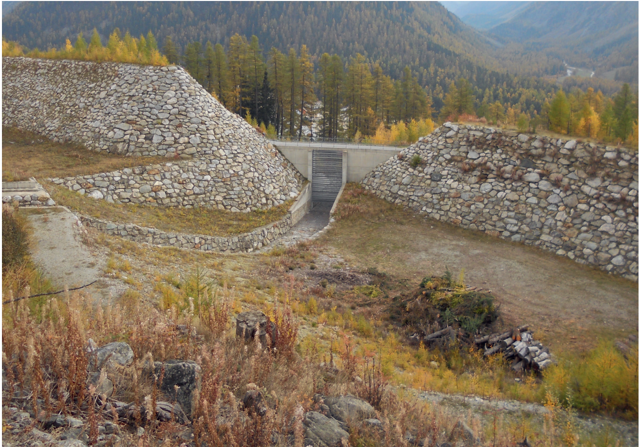
Die beiden Hauptdämme sind 205 und 230 m lang, an der Basis 70 m breit und bergseitig 12 m hoch.
