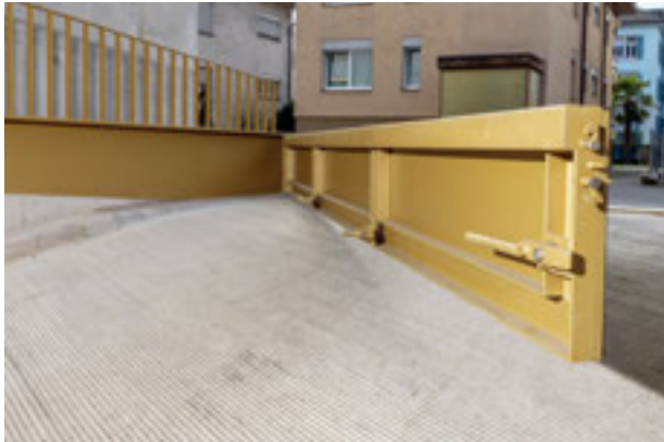
Das Nidwaldner Tor als mobiles, einfach bedienbare Schutzmassnahme bei Tiefgarageneinfahrten (weitere Informationen auf www.nidwaldnertor.ch ).
