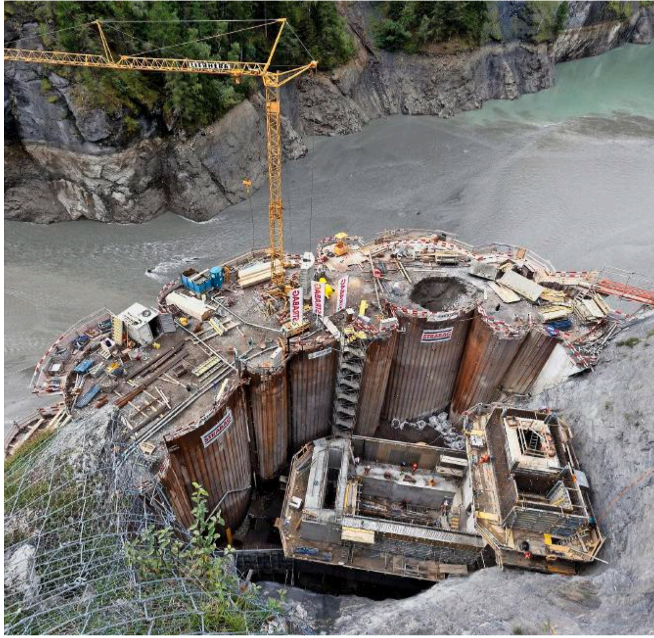
Um die Baugrube des Umleitstollens im Stausee Solis trockenzulegen, nutzt man einen Kreiszellenfangedamm (Bild). Foto: EWZ
